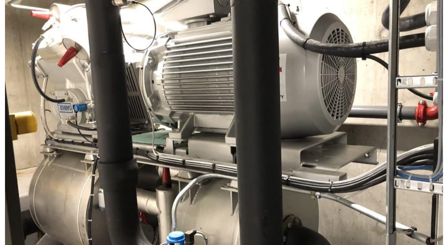
SABROE SMC 104 C I ENERGISENTRALEN I POWERHOUSE BRATTØRKAIA FOTO: NORSK VARMEPUPEFORENING
