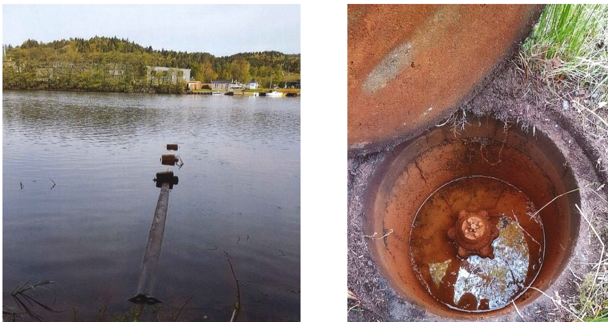
Figur 22: vannledning og vannkum fra Årøya over Mandalselva
