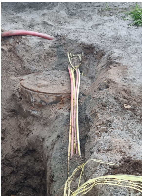
Figur 26: nedgravd kum i Mjunebrokkveien
