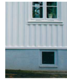
Malt pusset grunnmur. Ytre Sandgate 24b
