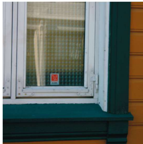
Nytt vindu (med feil glass) er plassert for dypt i den etterisolerte veggen.
