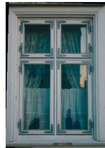
Nytt krysspostvindu med hjørnebeslag. Beslagene må males. Kastellgata 1
