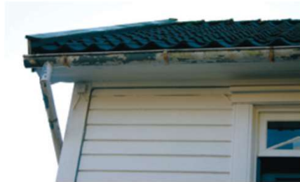
Eldre malt takrenne og nedløp. Giert Giertsens gate 20
