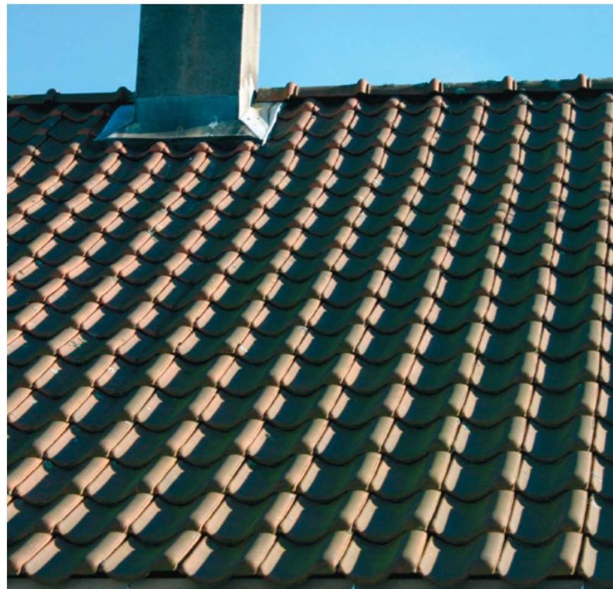
Tak tekket med en moderne teglstein med dimensjoner og utforming som ikke aksepteres i bevaringsområdene.
