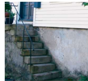
Ubehandlet pusset grunnmur. Giert Giertsens gate 20
